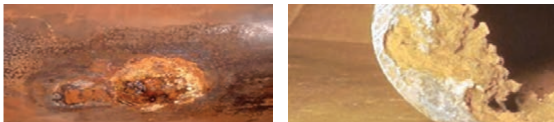
شکل ۳- برآمدگی و خوردگی ناشی از تشکیل رسوب
