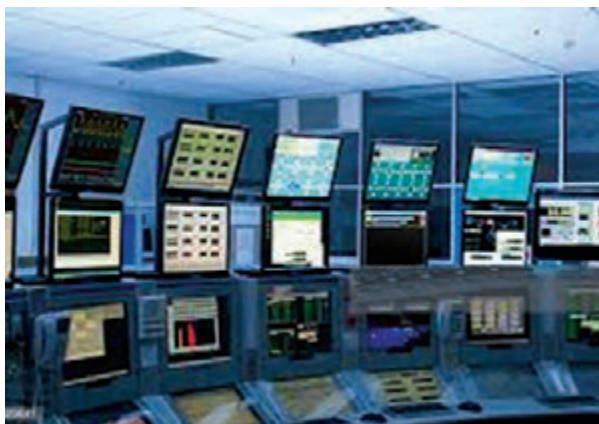
شکل ۲۸- نمایی از اتاق فرمان واحد
