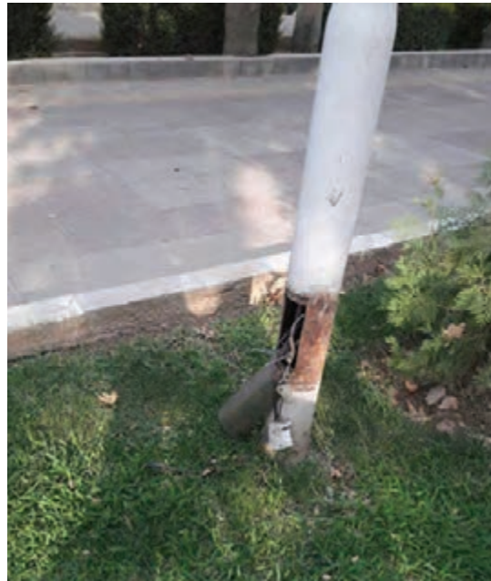
شکل ۲- وجود خرابی در سیستم برق کشی
