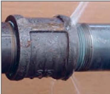
شکل ۱۱- یک اتصال در حال نشتی
