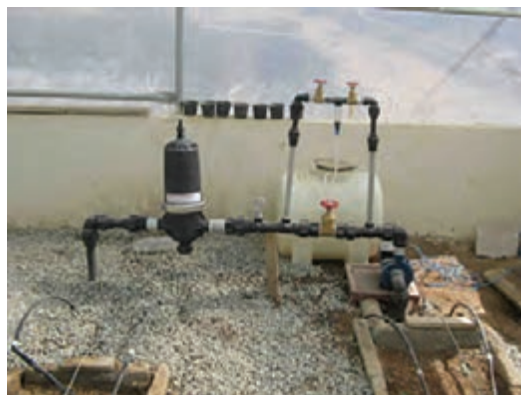
شکل ۱۴- نمونه‌ای از سیستم آبیاری گلخانه
