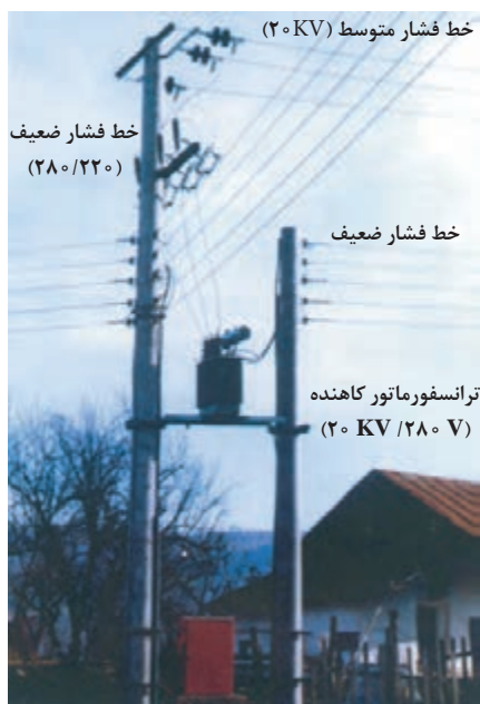
شکل ۲۷- خطوط فشاری متوسط و ضعیف هوایی برق
