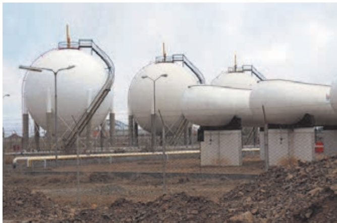
شکل ۴-۱۵ مخازن تحت فشار
