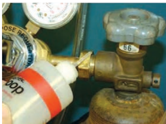
آزمایش نشتی بعد از بستن شیر تنظیم کننده
