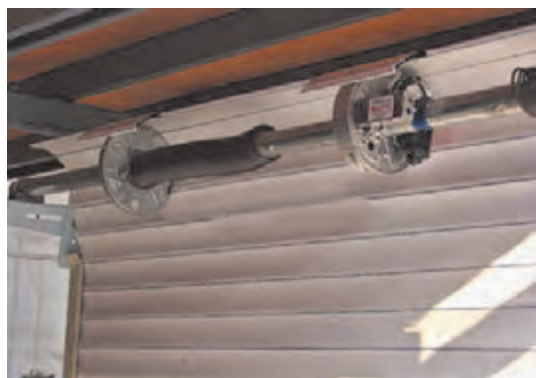
شکل ۱۱- محل نصب موتور کرکرهای
